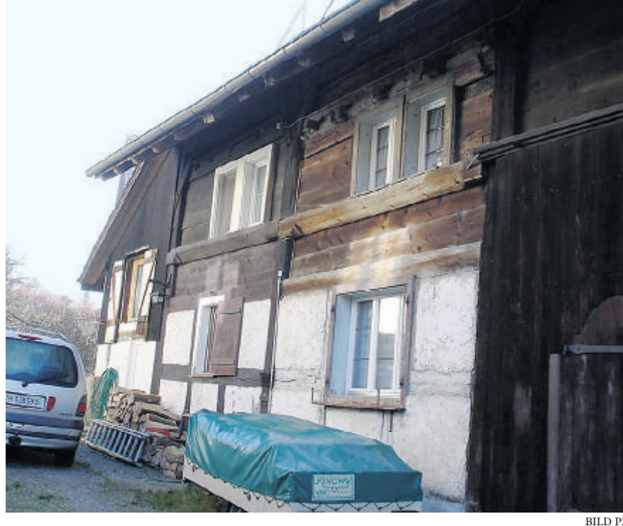
Für den Hausteil in Bohlenständerweise bestand keine Baufreigabe.
